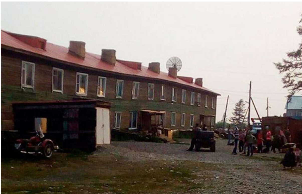
Рисунок 69. Такие дома в Аянке строили для специалистов, приехавших центральных областей России. Район таких домов прозвали Черёмушками. Этот дом просел в результате подтаивания вечной мерзлоты в жаркие дни
