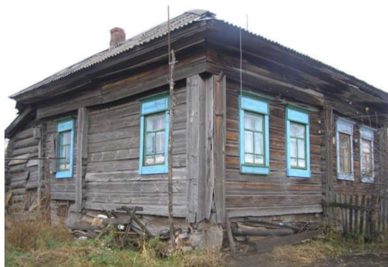
Рисунок 38. Дом обшит досками. Его преклонный возраст выдают углы венцов внизу. Но стоит он крепко, не покосившись от времени. Только справа фундамент чуть приосел. Вид с огорода (2012)
