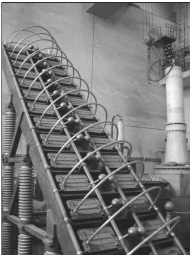
Генератор на 3 МВ установки «Стенд-3»
